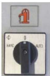
Figura 19: Bomba pressurizadora com chave seletora
