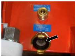
Figura 84: Tela filtrante na entrada de água
